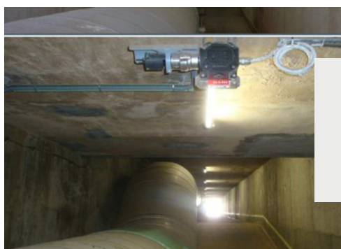
Iluminación Led en zona túnel peatonal
