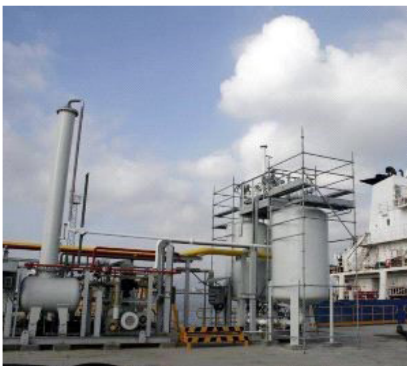
Unidad de recuperación de vapores (Fuente: CEPSA Refinería «La Rábida»)
