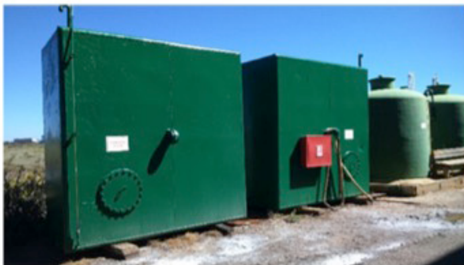
Planta desaladora de agua (Fuente: Drace Infraestructuras, S.A.)
