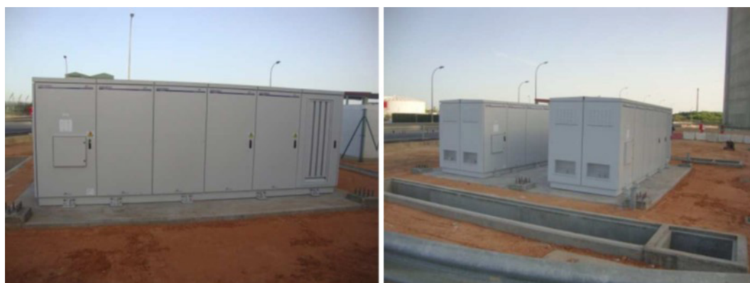
Variadores de frecuencia instalados
