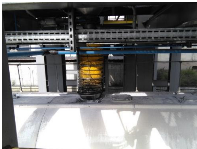
Manga telescópica en la carga de camiones (Fuente: García-Munté Energía, S.L.)
