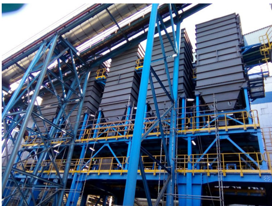
Filtro de mangas cerámico (Fuente: Atlantic Copper, S.L.U.)
