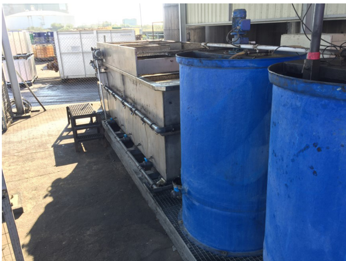
Planta de tratamiento de aguas
