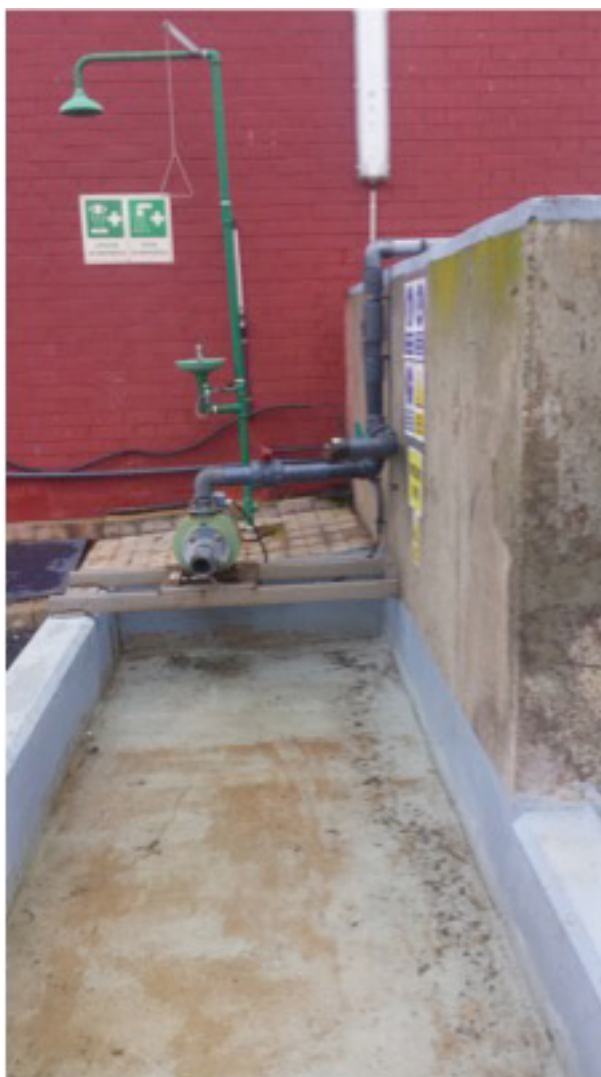
Sistema de válvulas y cubeto de recogida ante posibles derrames (Fuente: Empresa Municipal de Aguas de Huelva, S.A.)
