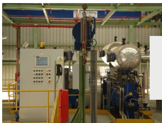
Compresor de recuperación BOIL-OFF
