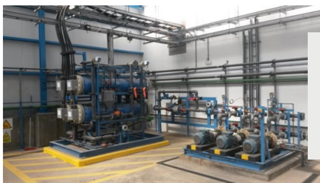
Interior de la planta de Electrocloración
