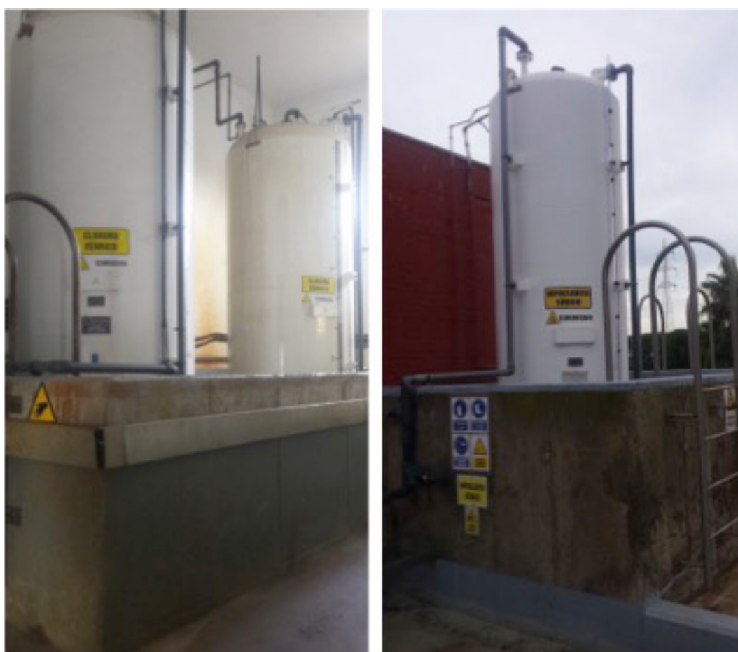
Cubetos de recogida de posibles derrames (Fuente: Empresa Municipal de Aguas de Huelva, S.A.)
