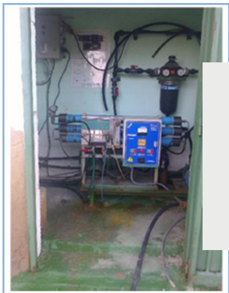
Interior de la planta desaladora de agua
