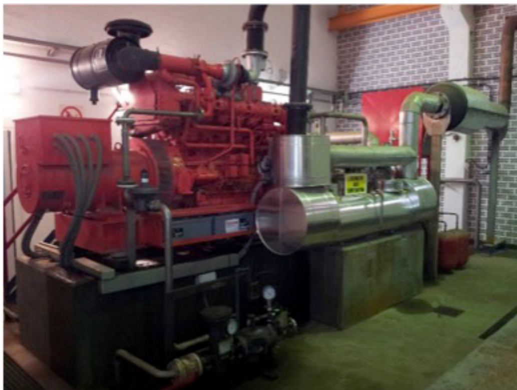
Grupo de cogeneración (Fuente: Empresa Municipal de Aguas de Huelva, S.A.)
