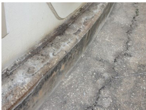
Estado inicial de juntas
