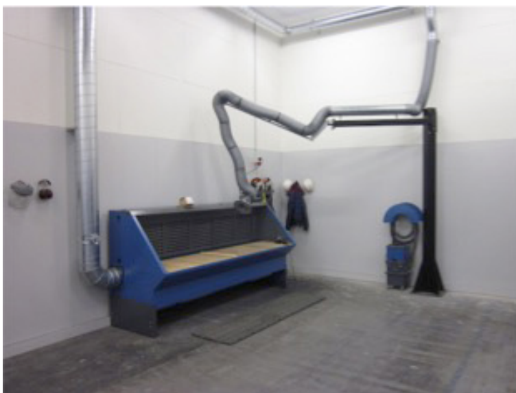
Mesa de extracción con ventilador y filtro integrado (Fuente: www.logismarket.com )
