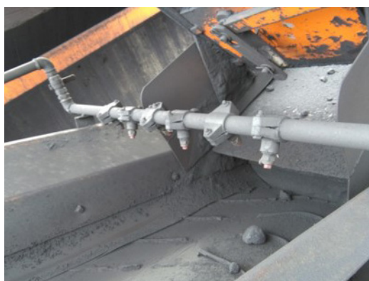
Rociadores de agua en cita transportadora
