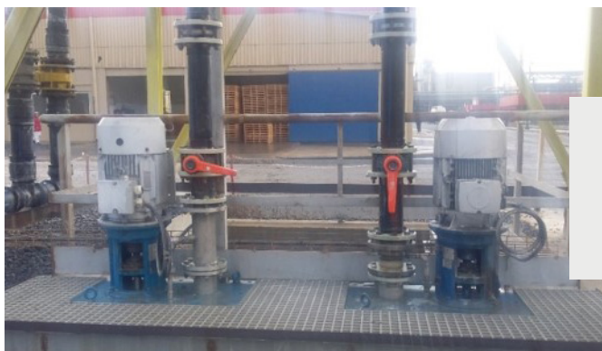
Punto de recogida y bombeo de agua hacia balsa de almacenamiento
