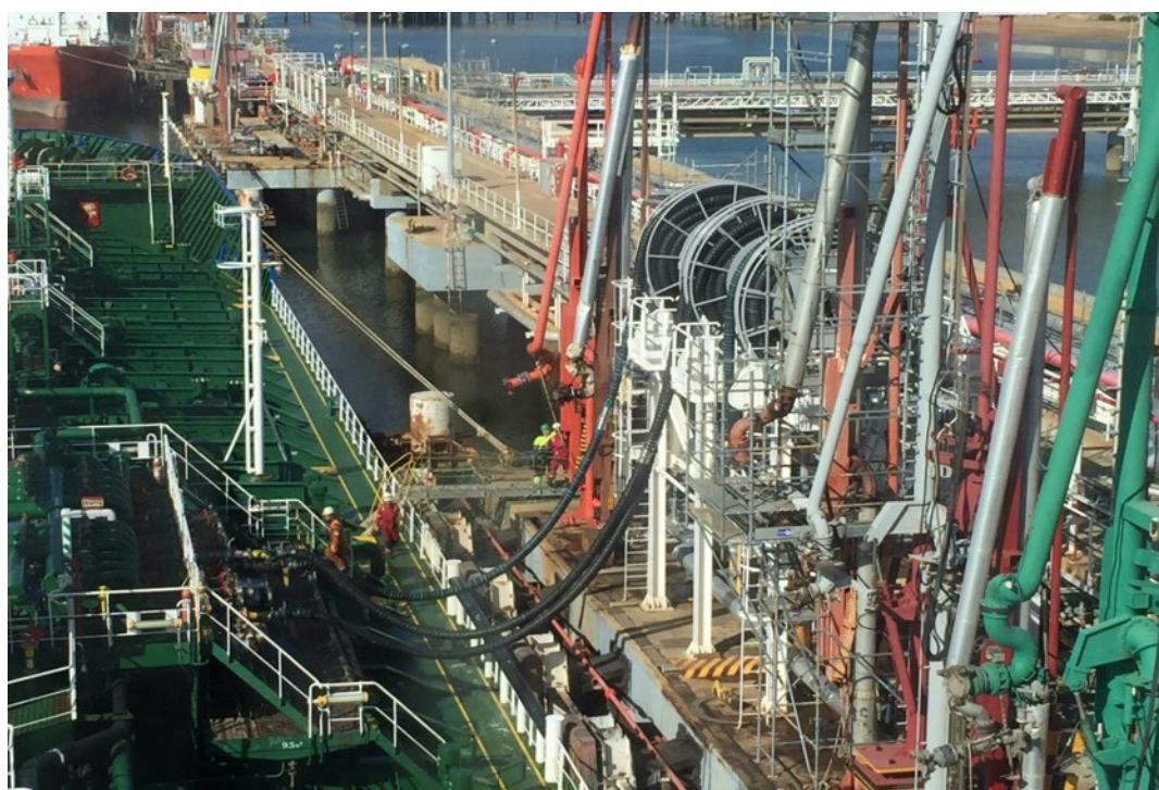
Sistema de carga y descarga mediante un novedoso sistema de mangueras (Fuente: Cepsa Refinería «La Rábida»)
