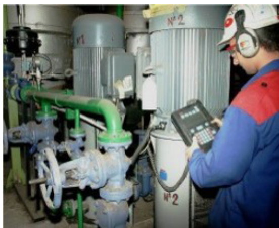
Medición de ruidos y vibraciones de una bomba vertical (Fuente: www.pemesa.eu )
