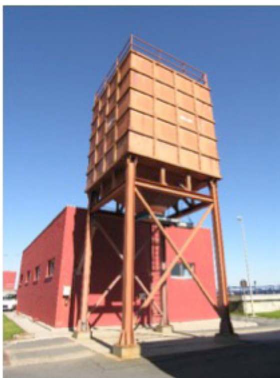
Silo para el almacenamiento de los fangos deshidratados (Fuente: Empresa Municipal de Aguas de Huelva, S.A.)
