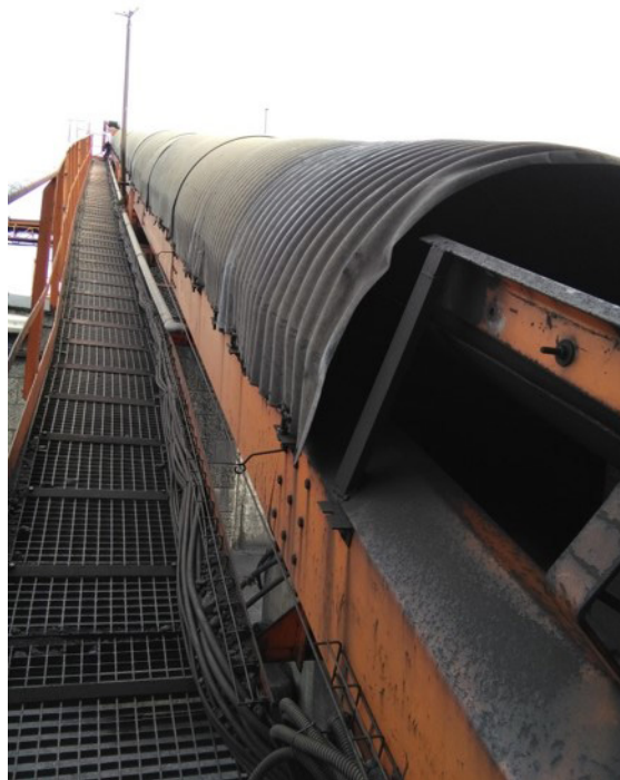
Cinta transportadora carenada (Fuente: García-Munté Energía, S.L.)
